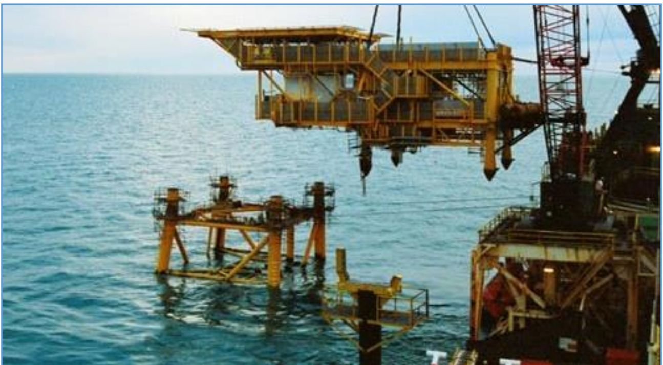
Figura 4 Izaje del Deck para su instalación sobre el Jacket preinstalado. Fuente: Total Austral
