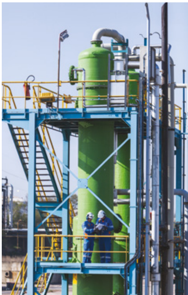
Station de Traitement des Eaux
