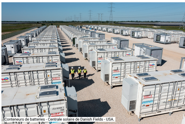
Conteneurs de batteries - Centrale solaire de Danish Fields - USA.
