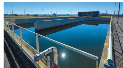
Bassin de récupération des eaux de pluie de la centrale à cycle combiné au gaz naturel de Bayet
