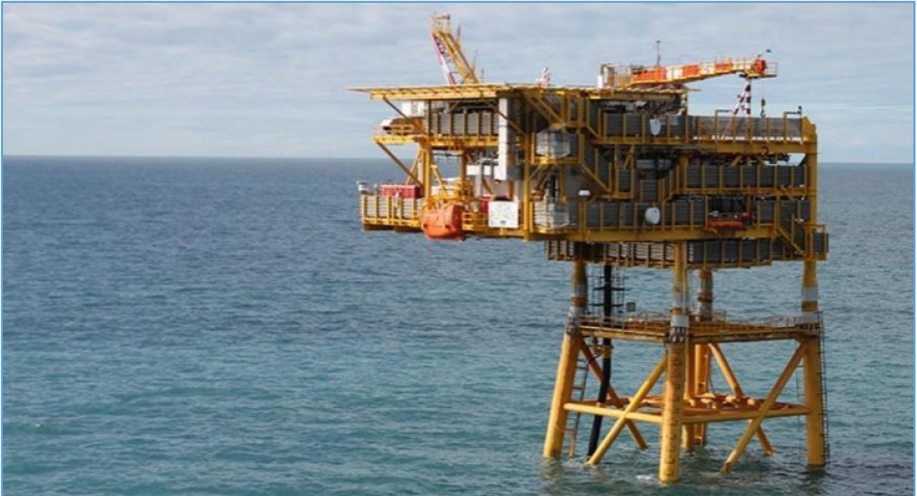
Figura 4.5.1.1.2 Plataforma de producción típica de Total Austral, frente a Tierra del Fuego
