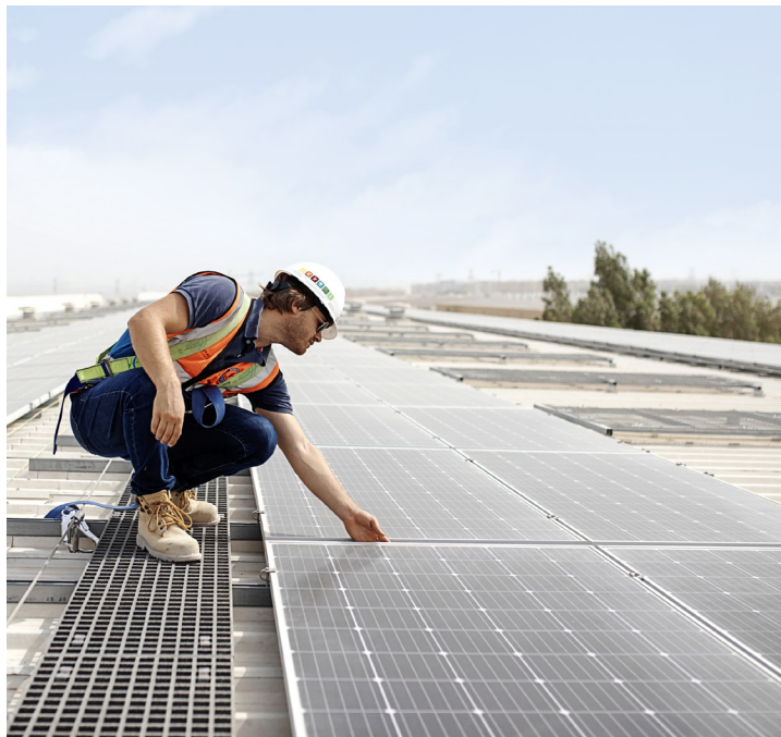
Panneaux solaires sur toiture aux Émirats Arabes Unis.
