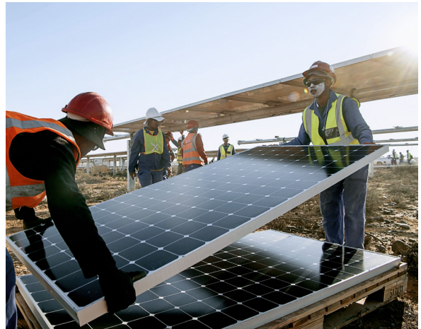
Centrale solaire SunPower Total, Prieska, Afrique du Sud.
