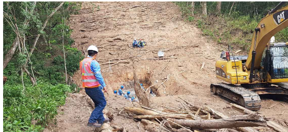
Inspección al DDV Línea de Recolección ICS-5, MSAI Samuel Rojas
