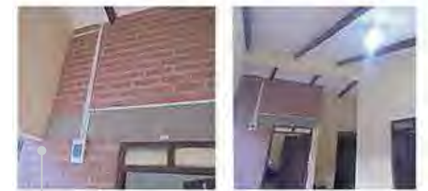
Sistema eléctrico mejorado - antes/después
